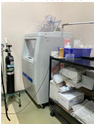
↓ オゾン水内視鏡洗浄消毒機 OED-1000S Plus: 2021年設置。
